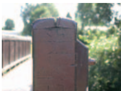
Bild 12 Risse im stark beanspruchten Handlauf, eine Hirnholzabdeckung wäre zudem nützlich
