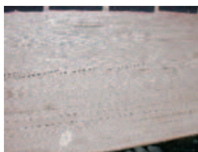
Bild 9 BSH-Träger mit Rissen in den Holzlamellen, nicht in den Klebefugen; auf Südseiten ein typisches Bild. Bekleidungen als Sonnenschutz, z. B. offene Verleistungen können dringend empfohlen werden.
