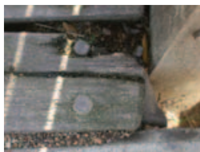
Bild 13 zu dicht gelagertes Auflager; erste Zerstörungen sind sichtbar.
