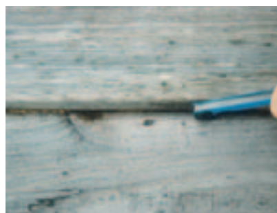
Bild 11 Klebfuge der Brücke 2 mit partieller Fehlverleimung, die ordnungsgemäß verklebten Fugen waren trotz teilweiser Veralgung der Brückenunterseite intakt.
