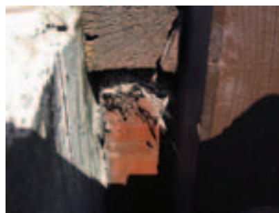
Bild 7 Brücke 3; nördliches Auflager mit direktem Kontakt zum Betonsockel
