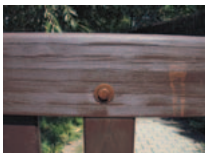
Brücke 6 Wetterbeanspruchter Handlauf mit Rissen in den Holzlamellen, die sich im Grenzbereich Klebstoffuge-Holzfortsetzen
