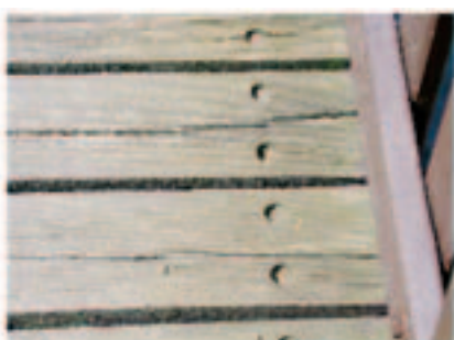
Bild 8 Befestigung der Bohlen; Regen und Schmutz bleiben in Senklöchern stehen.
